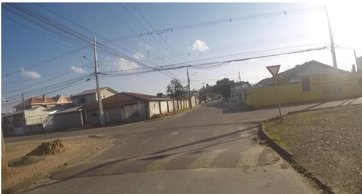
Figura 44 – Sinalização Horizontal e Moderação de Tráfego em condição ruim (Rua Cambará)
