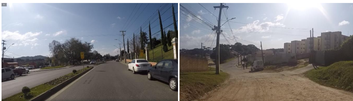
Figura 42 – Pavimentação em condição ótima e ruim/inexistente (Rod. Antônio Gasparin e Rua Aíres Fernandes da Silva)
