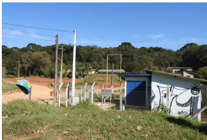
Figura 73/III - Captação de água no entorno, SANEPAR
